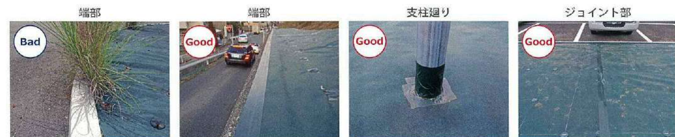
施工が悪く、雑草が生えています。
