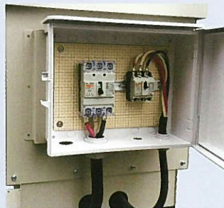
ブレーカー BOX IP44 (後付け可能)
