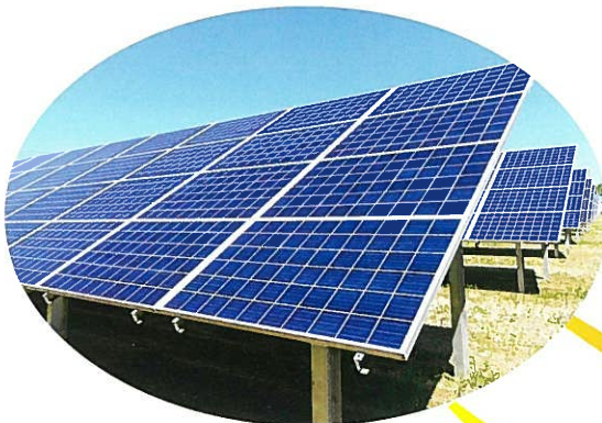
太陽光パネル
