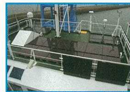
船内に搭載された移動・取り外し可能な太陽光発電システム(3kW)
